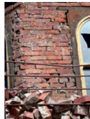
(d) Metal wall ties badly deformed.
