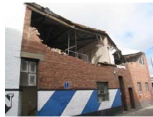
(d) Failure of long wall
