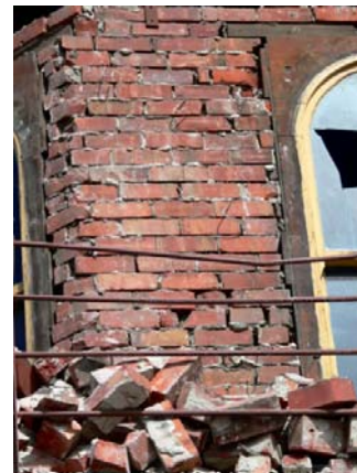
(d) Metal wall ties badly deformed.
